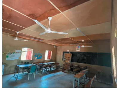
Salle de classe avec éclairage et ventilation
